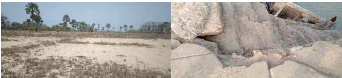
Figura 4: Estado atual de bolanha em Djufunco e rampa de cais em Bolama
