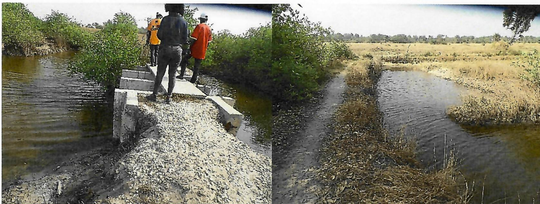
Foto 8: Aqueduto com comportas para a protecção e dique em estado precário
